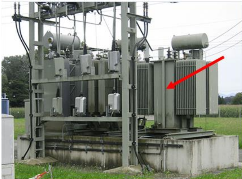
Kühlmittel in Transformatoren
